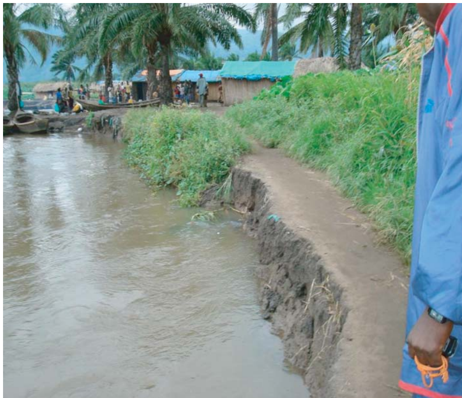
Photo n°5: Erosion et dégradation des rives de la rivière Kakoï
