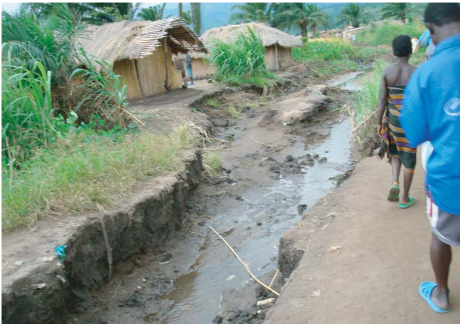
Photo n°4: L'érosion en plein village de NDARO
